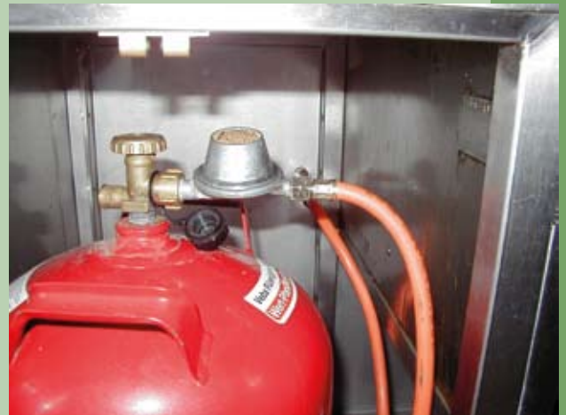
Fehlende Schlauchbruchsicherung und falscher Druckregler.
