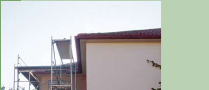
Fehlende und unvollständige Gerüste bei einer Dachsanierung auf einer Baustelle im Regierungsbezirk Unterfranken durch Dachhaie.
