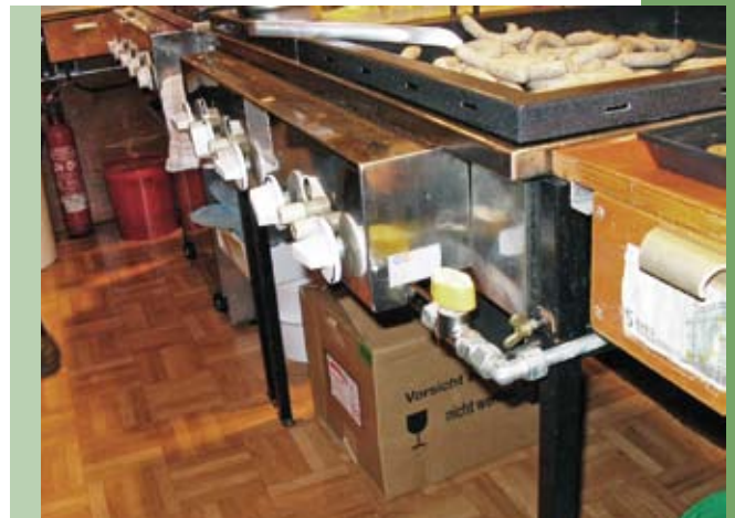
Grill mit vorschriftsmäßig fest verlegten Anschlussleitungen.
